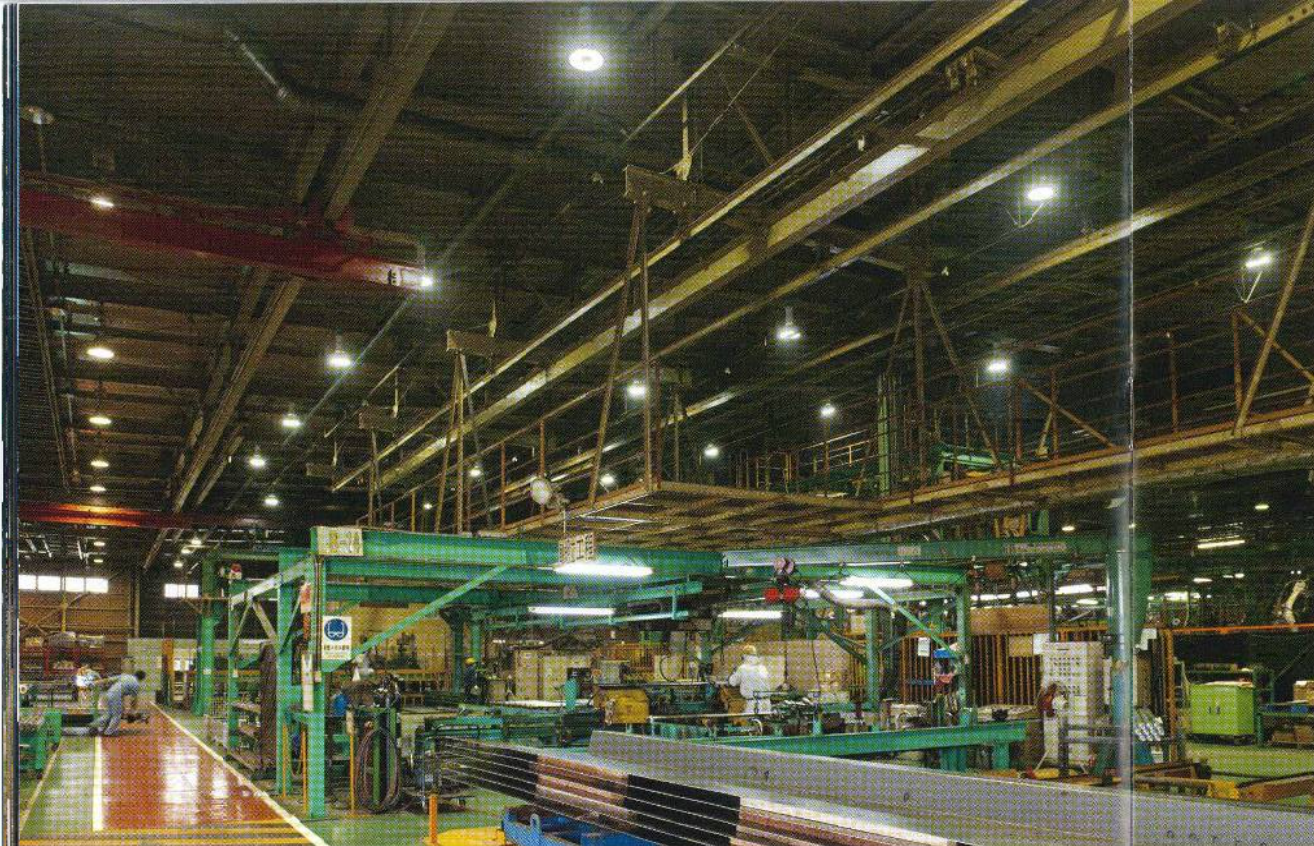
LED高天井用照明器具(レディオック ハイ ベイ ラムダ)の爽やかな光が工場内の色味を鮮やかに照らし出す。 Invigorating light from LED high-ceiling lighting fixtures (LEDioc HIGH-BAY A) illuminates the vivid colors of the factory interior.
