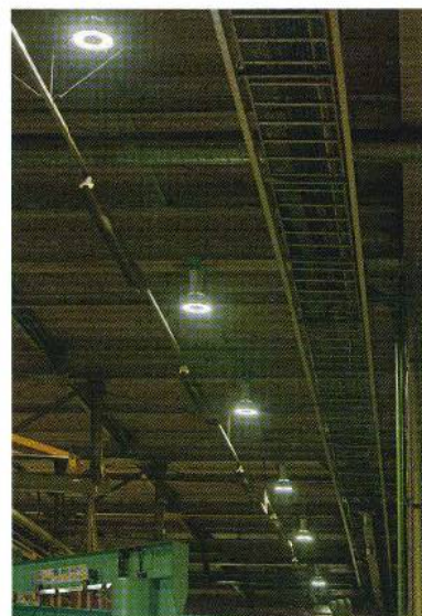
LED高天井用照明器具(レディオック ハイ ベイ ラムダ)設置状況。LEDは瞬時点灯可能で点灯/消灯をこまめに行えるため、さらなる節電を可能にしている。 The installed LED high-ceiling lighting fixtures (LEDioc HIGH-BAY A). They can be turned on/off instantaneously, allowing for precise on/off lighting, making further power conservation possible.
